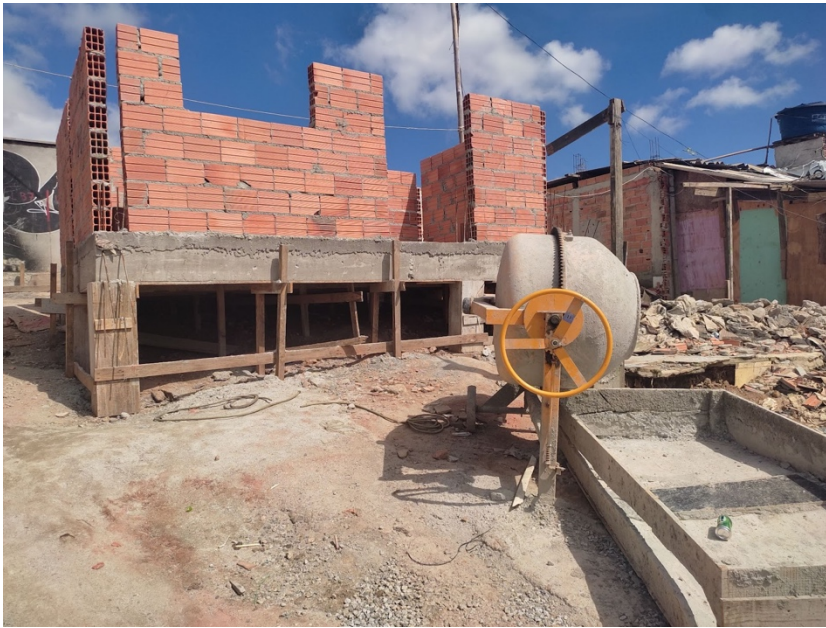
Figura 7. Casa embrião com obra em andamento, na etapa de alvenaria (fonte: acervo dos autores, São Paulo, 2022).
