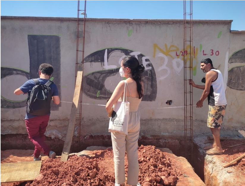
Figura 6. Momento de marcação de um dos lotes previstos no Plano Geral de Urbanização elaborado pela assessoria técnica. (fonte: acervo dos autores, São Paulo, 2022).
