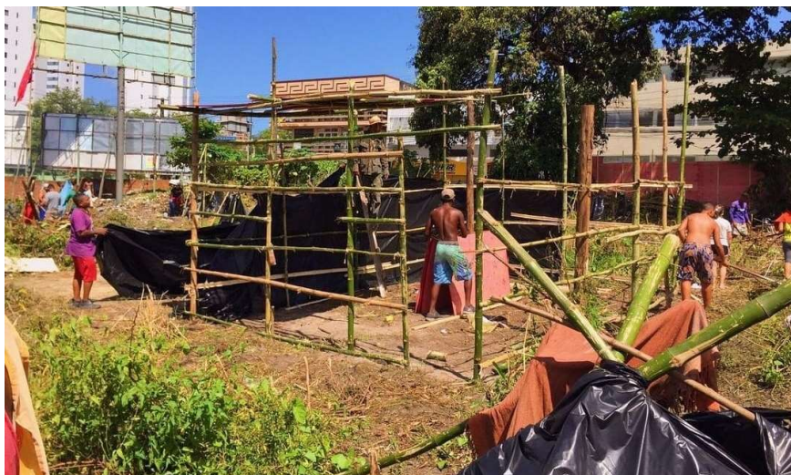
Foto 1. Estrutura da cozinha comunitária – uma das primeiras construções na Ocupação 8 de Março (fonte: co-autora Lahys Barros, 2021).
