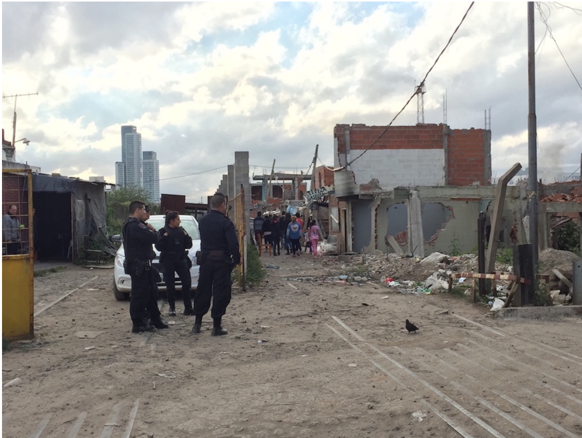
Imagen 2: Viviendas derrumbadas para el futuro cambio de traza de la Autopista Illia. Fuente: Archivo personal de las autoras.
