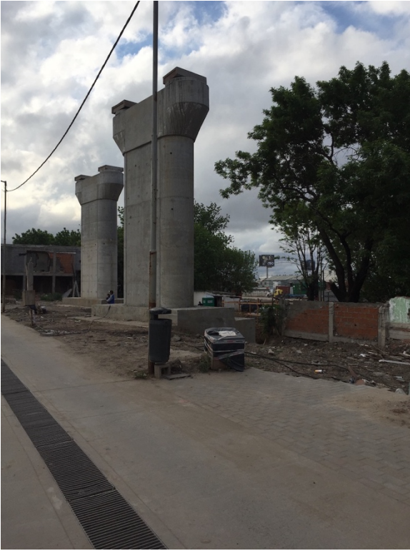
Imagen 1: Pilotes construidos para el futuro cambio de traza de la Autopista Illia. (Fuente: Elaborado por las autoras.)
