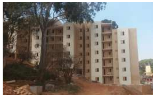
Imagem 6 – Empreendimento Barra do Jacaré localizado no município de São Paulo. Programa MCMV-E de grande porte com 592 uh. Assessoria técnica Brasil Habitat. Fonte: acervo Brasil Habitat.
