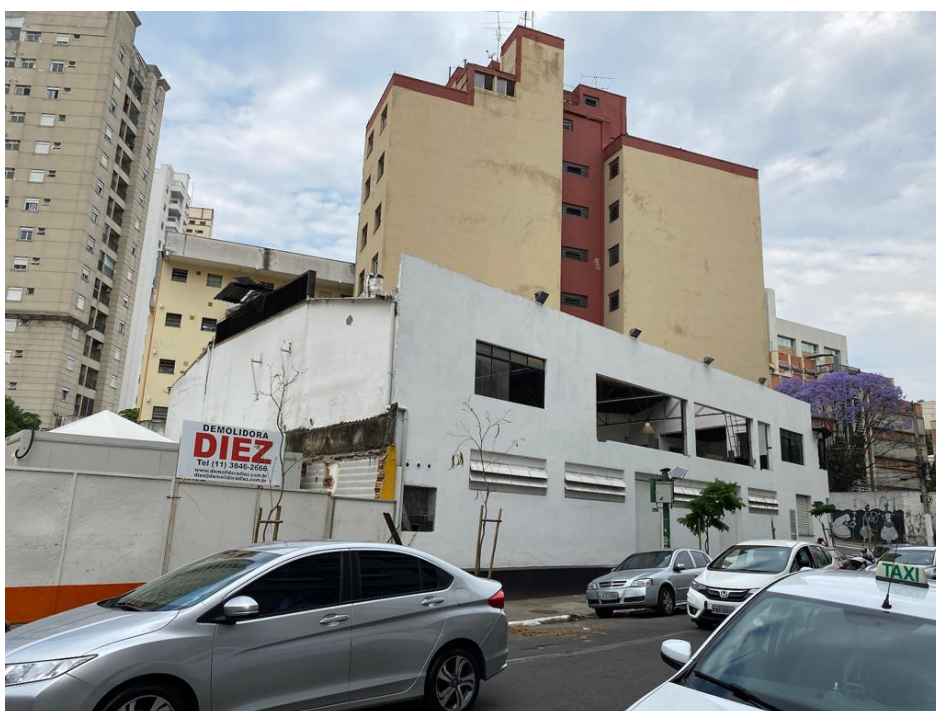
Figura 15: Demolição da Quadra do Vai-Vai para construção da Estação 14 bis do Metrô. Autor: Felipe Neres, 2021.
