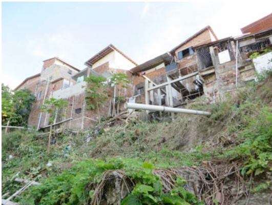
Figura 2. Residências em área de talude exposto a processos erosivos, Comunidade Santa Bárbara, bairro Castelo branco (fonte: CPRM, 2019).
