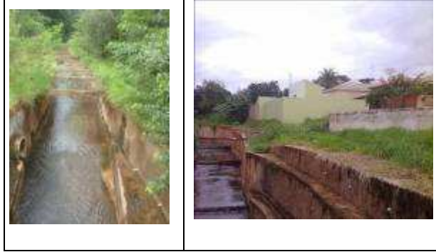
Figura 5: Córrego Monjolinho em Ourinhos - canalização, dificuldade na transposição e invasão das margens.
